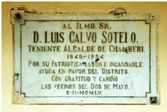
61.- Lápida en mal estado de conservación, en fachada de la iglesia de Nuestra Señora de las Maravillas y Santos Justo y Pastor.
